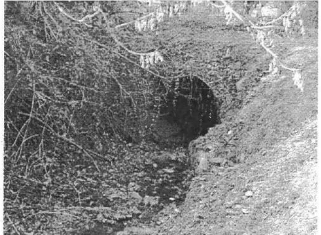
Le busage du ruisseau de Ruy-Jaillet avant son rejet à la Bourbre
